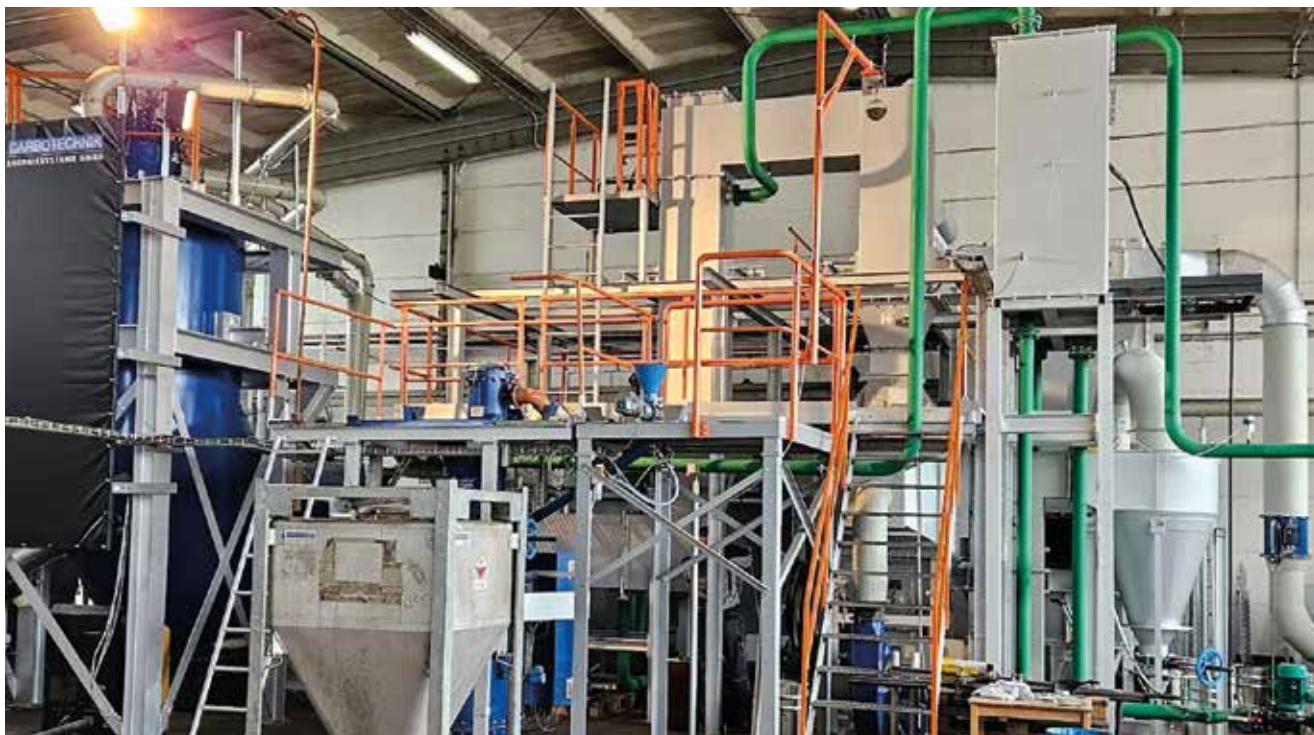
Pilotanlage der Carbotechnik Staubfeuerung am Standort Magdeburg. © Carbotechnik
